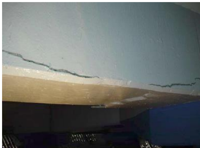
写真-3 第7バース：一般梁部の再劣化の例
