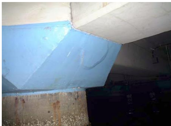
写真-2 表面被覆部の再劣化の例（杭頭部）
