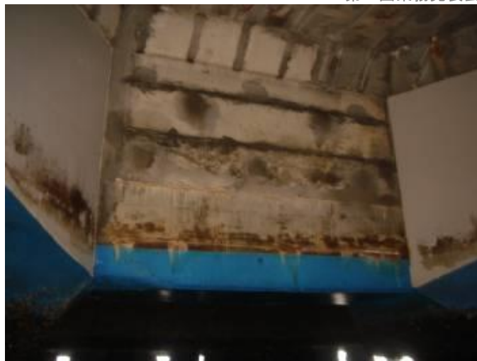
写真-5 縦置き帯状陽極の変状の例
