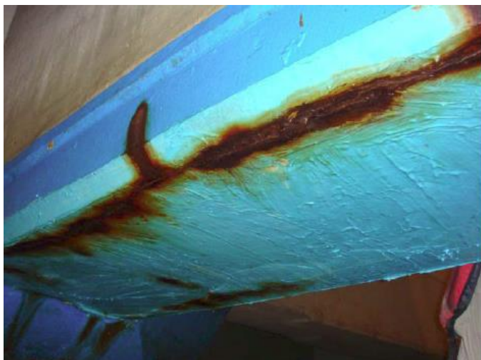
写真-4 第7バース：クレーン桁部の再劣化の例
