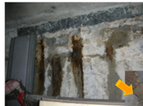
施工前 最大20ℓ/分の漏水（漏水版内側）
