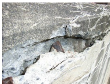
写真 2.3.4 L 側桁部内側の状況 (破断鉄筋の露出)
