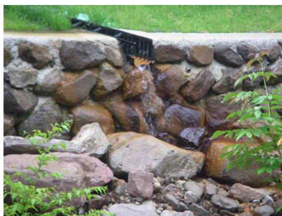
写真-3 排水溝の河川落ち口
