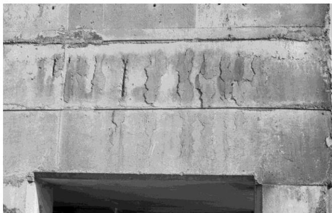
写真 - 1 コンクリートの剥落事例
