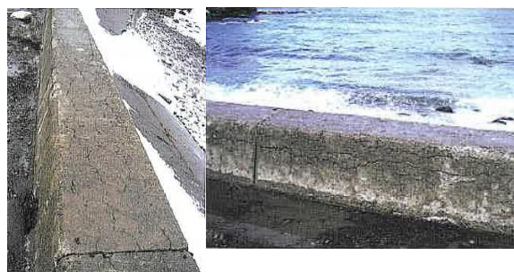
写真1 事例1:防波堤パラペット
